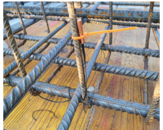
Sensor CoSMoS™ instalado en forjado
